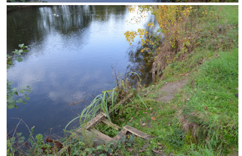
Figure 42 - De haut en bas, Masse arborée composant la coupure, coupure de Bruyelle et plateforme sur la berge dégradée (Source : C. Dhellemmes, 2022)
