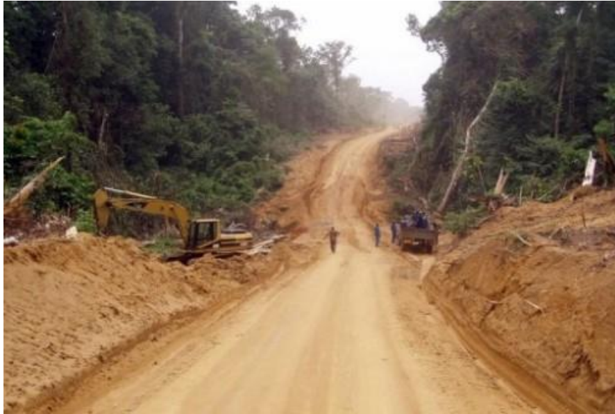
Figure 6. Construction de la route à la périphérie Ouest de la RBD (source Mélanie Bawou, Avril 2022).
