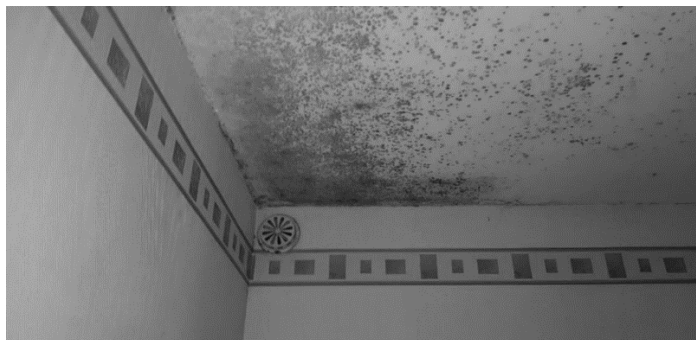
Fig. 60 - Apparition de moisissures Source : Cyrille Michel
