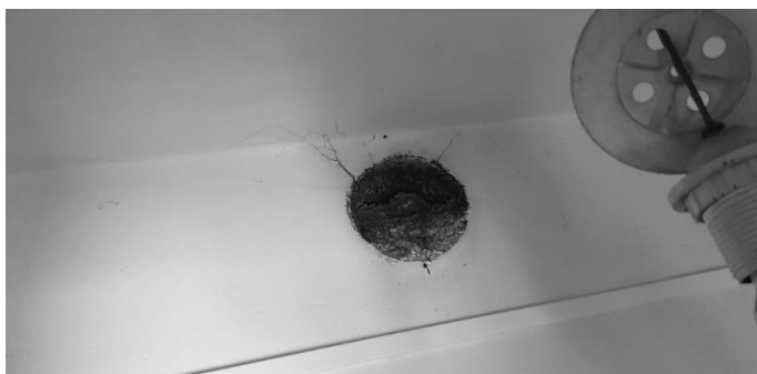
Fig. 61 - Bouche de ventilation bouchée Source : Cyrille Michel
