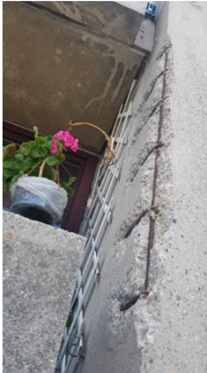
Fig. 11- Dégradation du béton due à la carbonatation Source : Cyrille Michel
