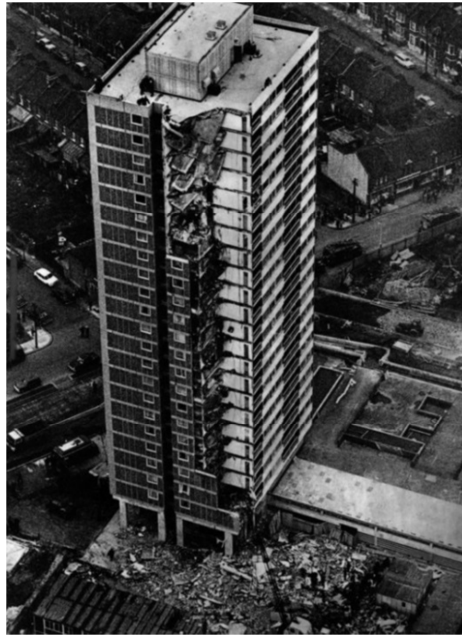
Figure 2 : Effondrement du Ronan point (vue aérienne) 7
