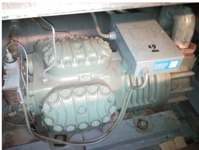
Figure 10 : Compresseur du chiller
