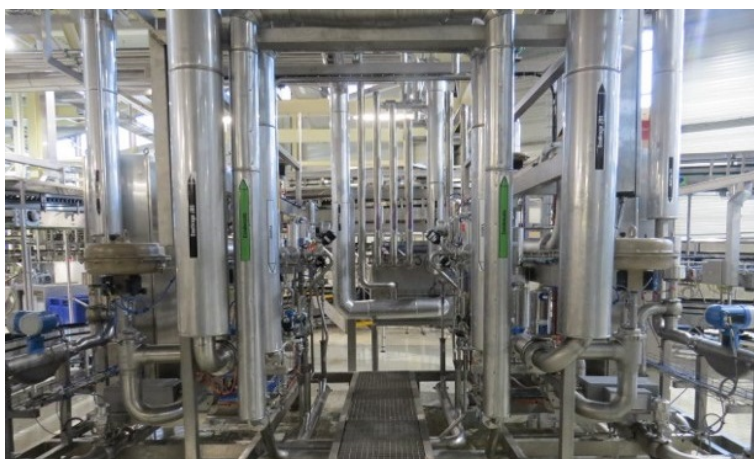
FIGURE 2.7 – Carbonateur - Alimentation de la soutireuse en fluides.
