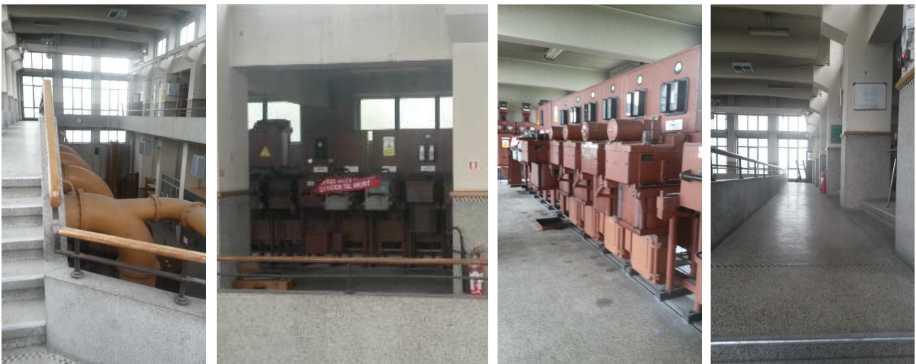
Fig.139 : Vues de la salle des transformateurs
