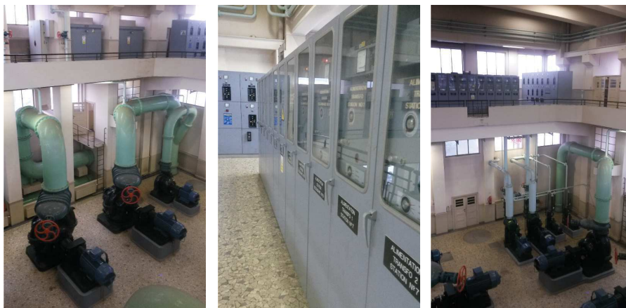
Fig.108 : Vues de la salle des transformateurs
