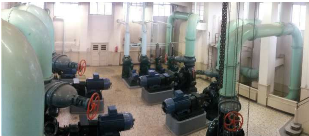
Fig.110 : Vues de la salle des pompes
