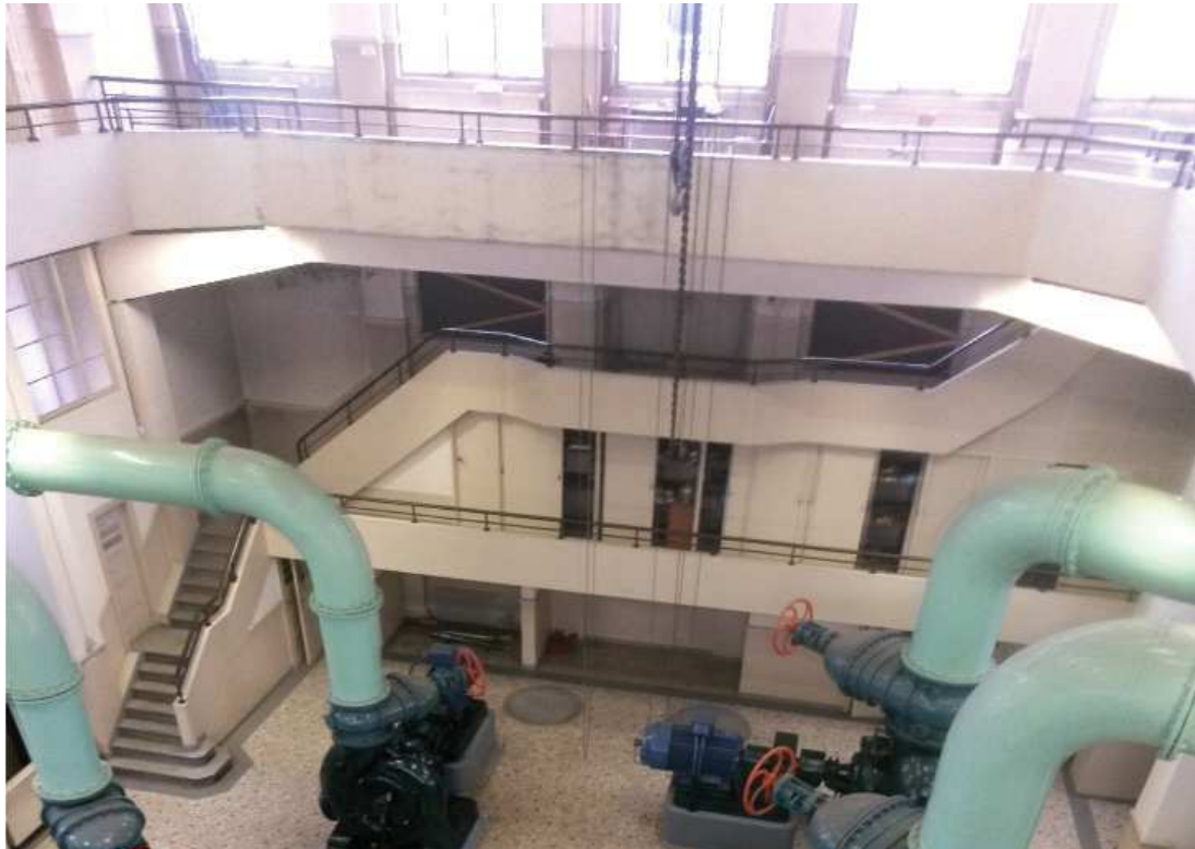
Fig.122 : Vue en plongée sur la salle des pompes
