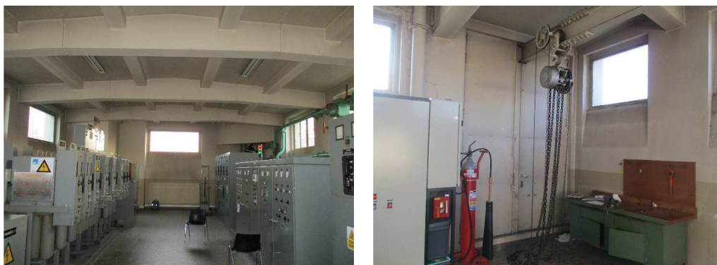
Fig.77 : Vues de la salle des transformateurs
