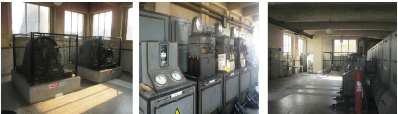
Fig.46 : Vues de la salle des transformateurs
