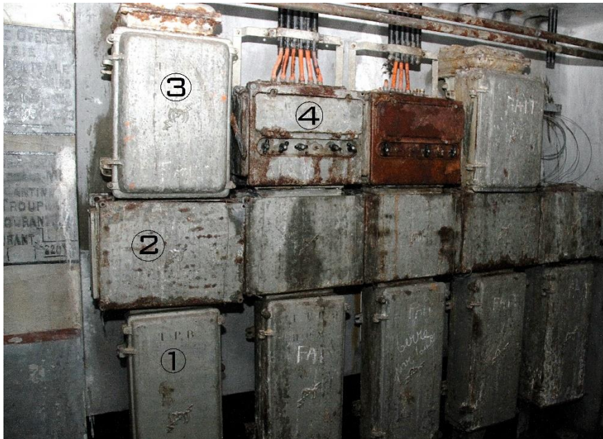
Figure 57 Tableau divisionnaire du fort de Tancrémont. Photo personnelle.
