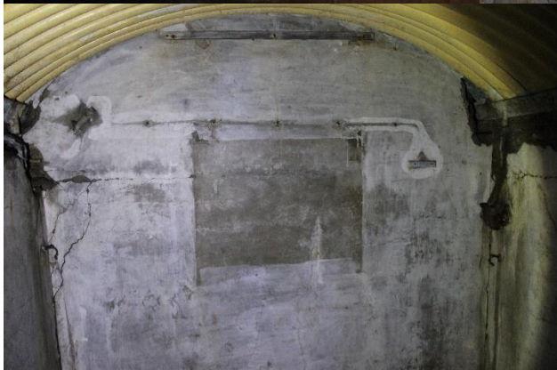
Trace d'équipement inconnu, prise et boîte de dérivation. Bloc opératoire, fort de Fléron (photo personnelle).
