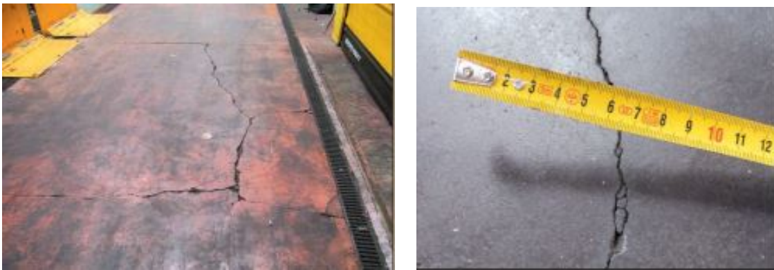
FIGURE 4.1 – Fissures induites par du retrait [14]
