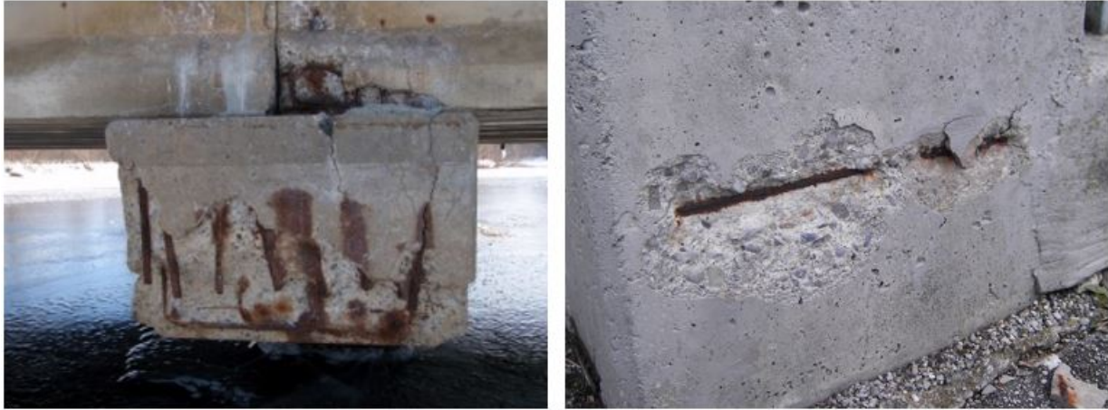
FIGURE 4.3 – Exemple de dégâts provoqués par la carbonatation [22]
