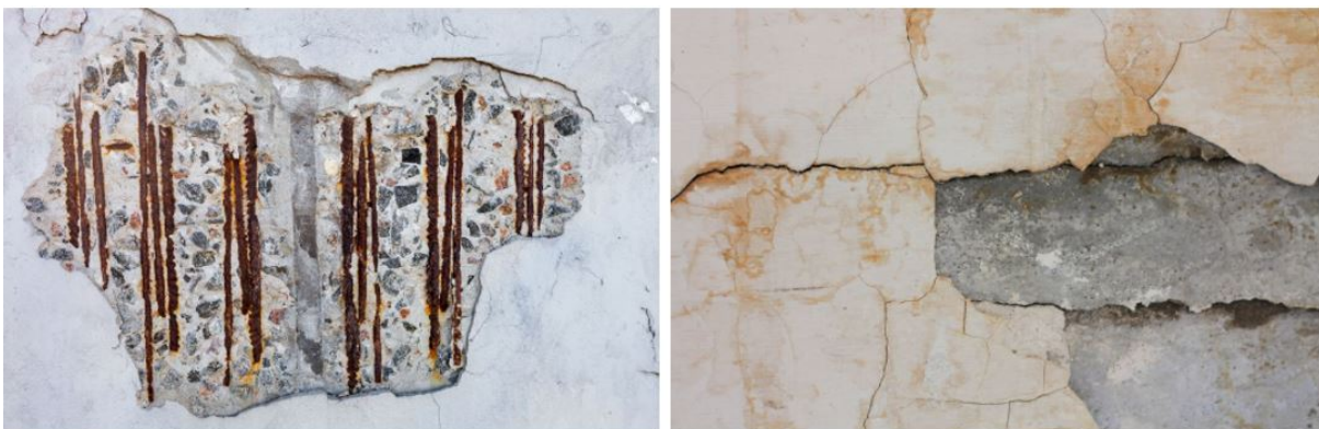
FIGURE 4.6 – Dégâts engendrés par l'attaque des sulfates sur le béton [36]
