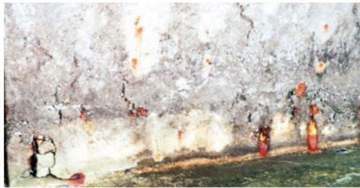
FIGURE 4.5 – Dégâts engendrés par la corrosion des armatures par les ions chlorure [18]
